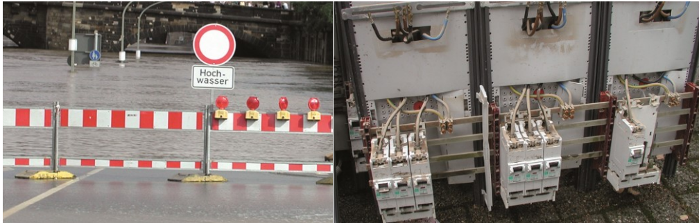
Verteiler nach dem Ausbau aus dem Hochwasser
