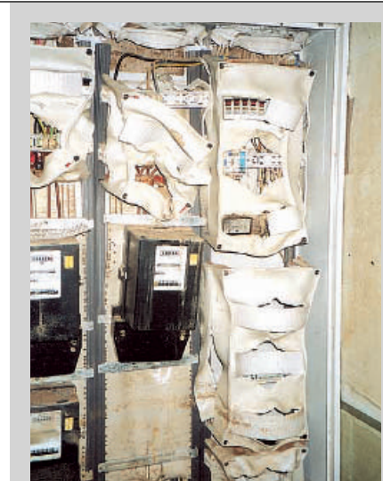
1 Bei Nichtauslösen der Überstrom-Schutzeinrichtungen im Wasser erhitzte und deformierte Kunststoffteile von Betriebsmitteln
