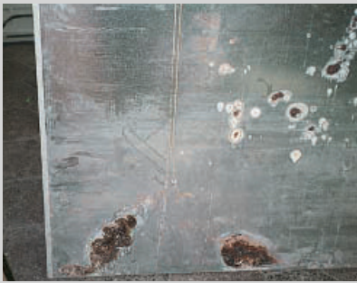
2 Korrosion eines Verteilergehäuses durch Hochwasser
